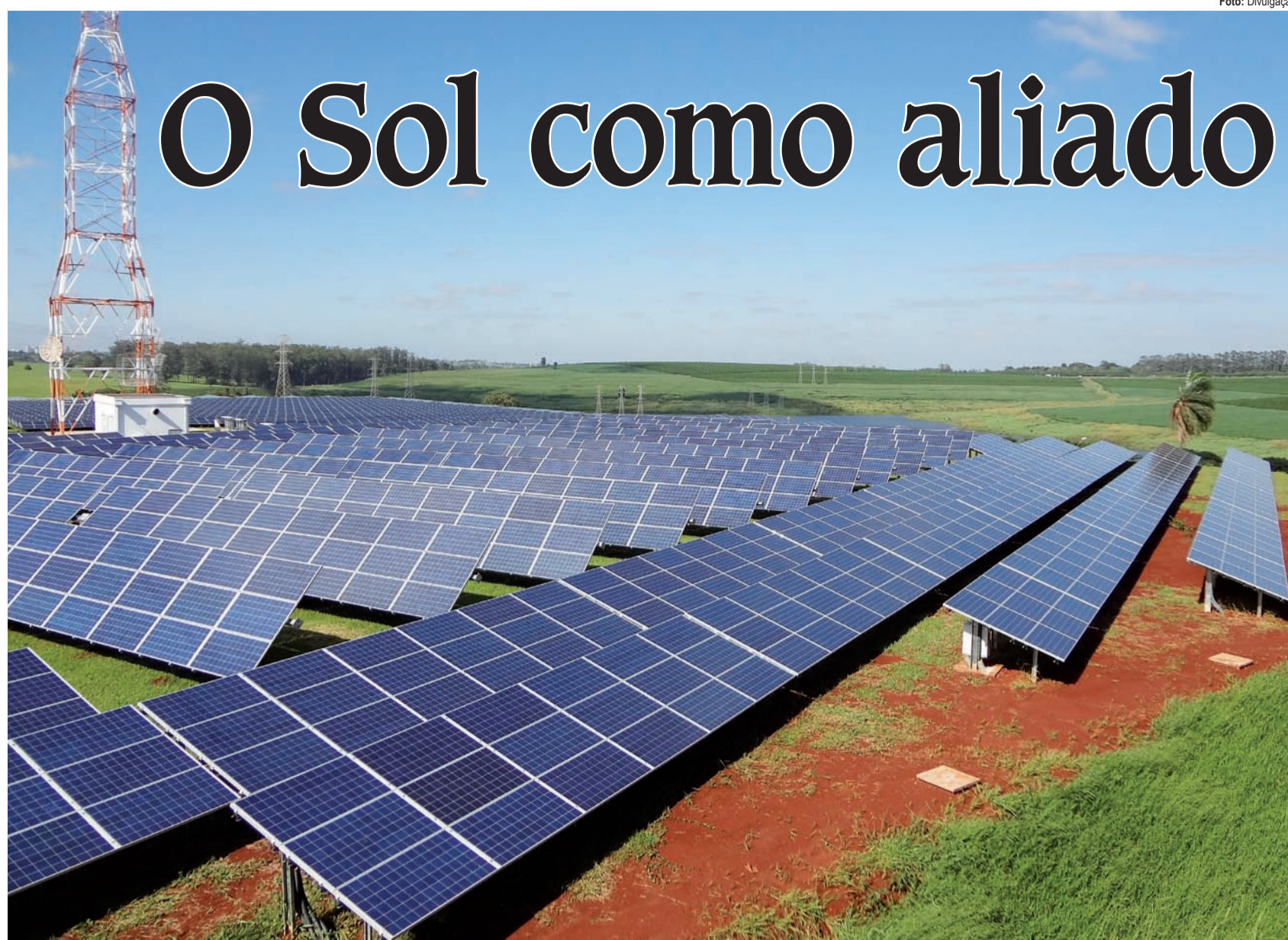
Planta colocada em operação pela CPFL: unidade serviu de referência para a pesquisa inédita em torno da Chamada Estratégica Nº 13 da Aneel
