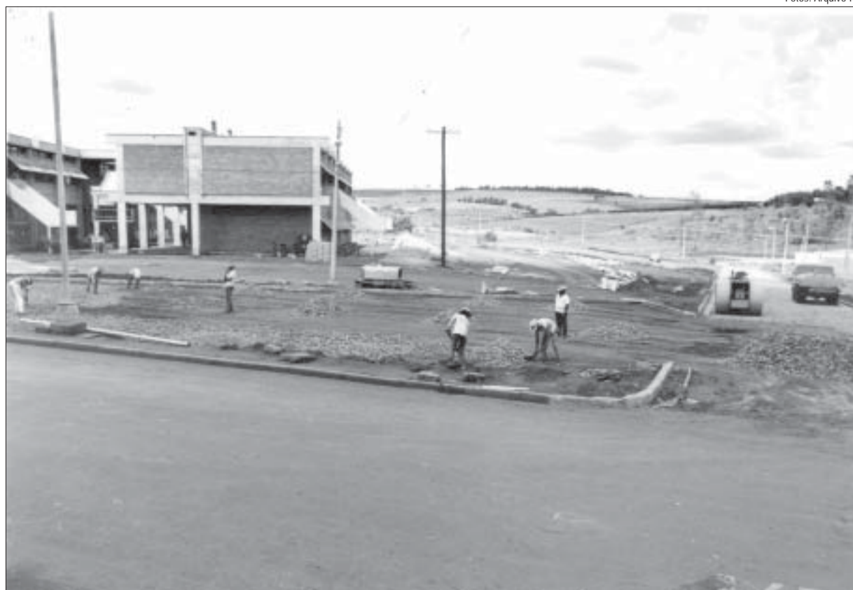
Vista parcial do prédio do Instituto de Química em fase de construção, em 1970: "milagre econômico" garantiria convênios
