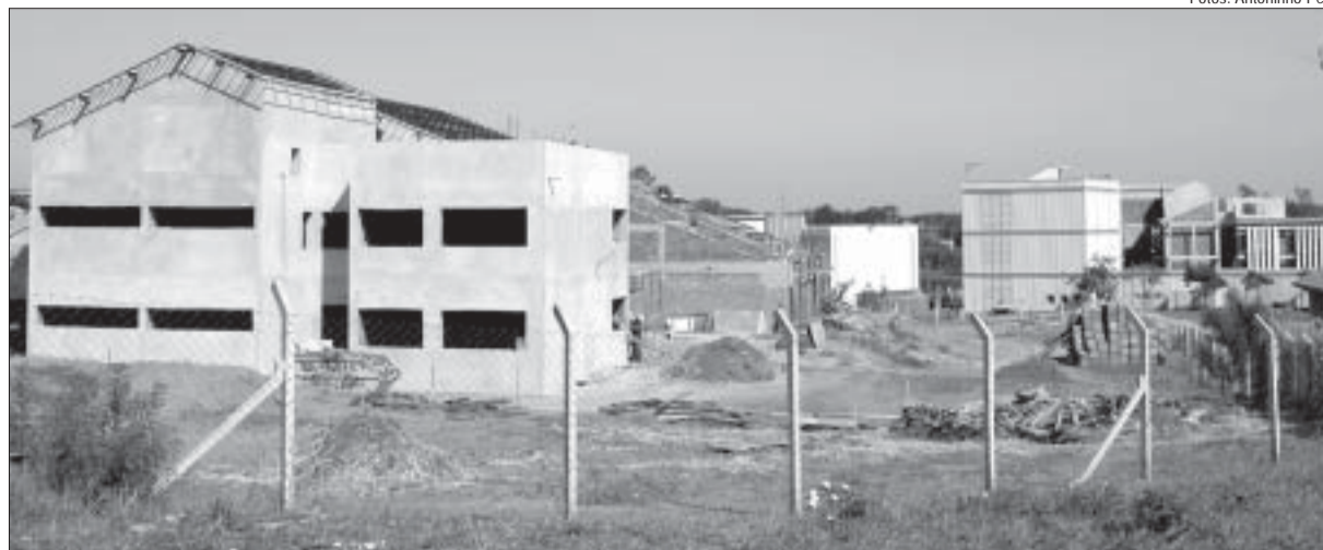
Em primeiro plano, obras do novo prédio do Arquivo Edgard Leuenroth; ao fundo, local onde funcionará o Cepetro
