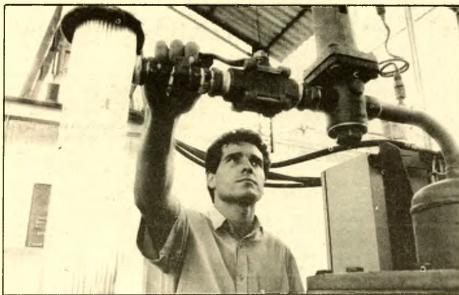
Andrés aciona o sistema de refrigeração acoplado às caldeiras do HC.
